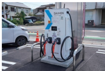
EV急速充電設備
